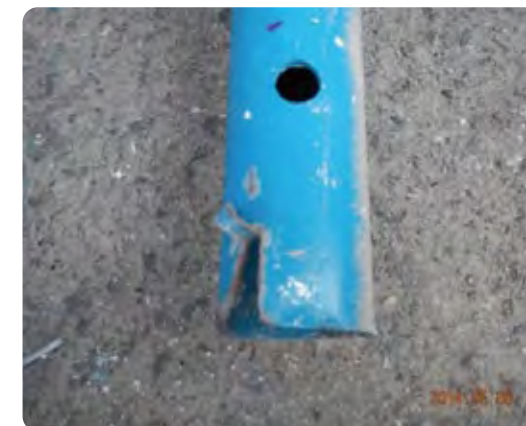
A-5 ・切断、亀裂、穴開き等の破損
