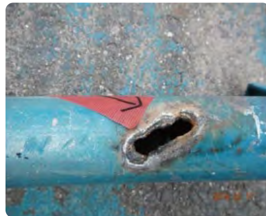
A-9 ・切断、亀裂、穴開き等の破損
