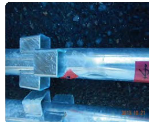
A-2 ・パイプ部分の曲り、変形、へこみ
