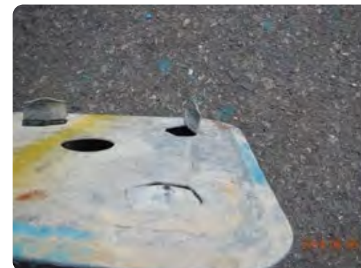
ツメ部分の変形
