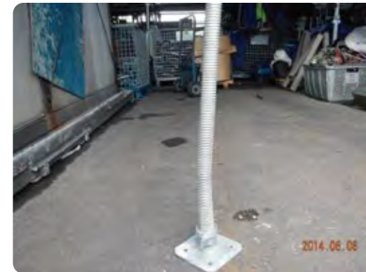
ネジ管部分の曲り
