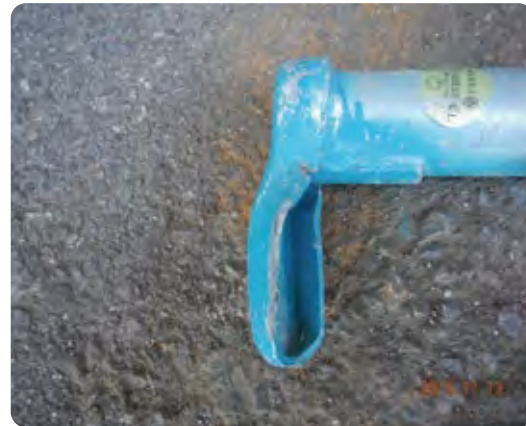
A-6 ・クサビ部分の変形、亀裂
