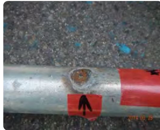
A-9 ・切断、亀裂、穴開き等の破損
