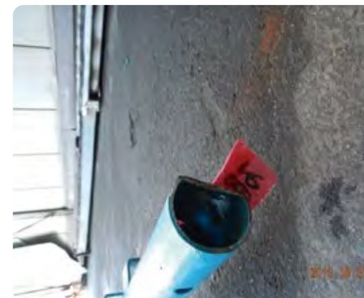
A-1 ・端部やジョイント部分の曲り、変形
