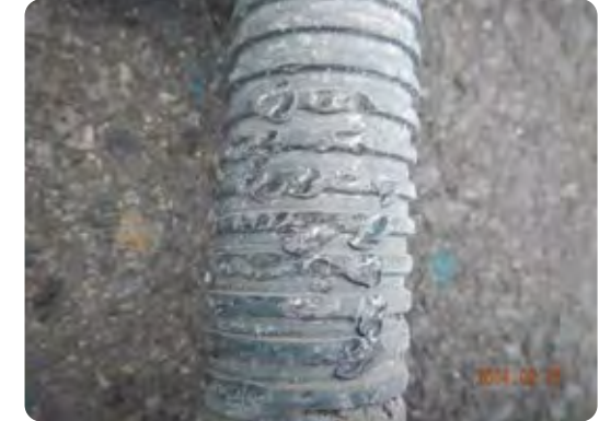
ネジ管部分のへこみ
